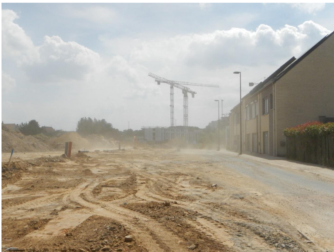
Figure 4-11 : Nuisances dues à la poussière à cause du chantier à hauteur de la rue Delwart et de la rue des Trèfles (Source: visite sur le terrain juin 2017).
