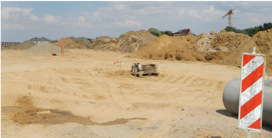
Figure 4-12 : Parcelles agricoles à hauteur du carrefour rue des Trèfles/rue Delwart au moment de l'élaboration du PPAS (au-dessus, source : reportage photographique du RIE) et chantier présent lors de la visite sur le terrain en juin 2017 (en-dessous).
