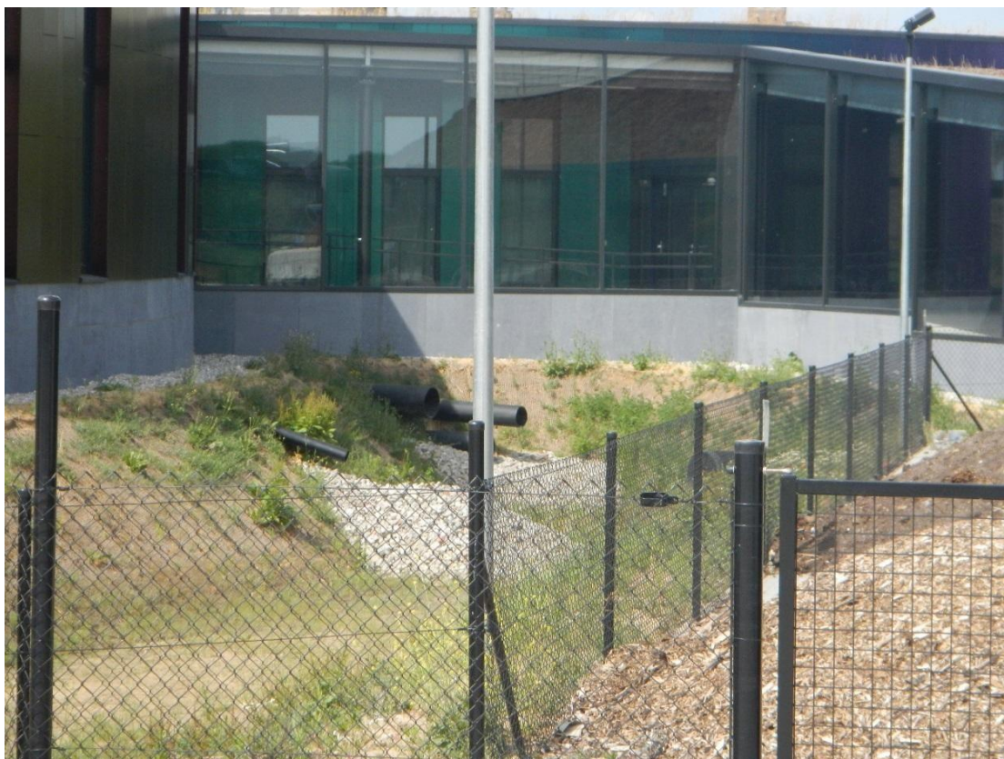
Figuur 4-18 : Open stormbekken aan de school (Bron : terreinbezoek juni 2017).
