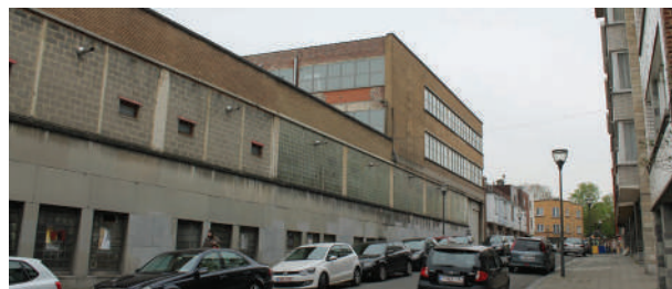
Les fenêtres sont bouchées depuis les dernières rénovations.
