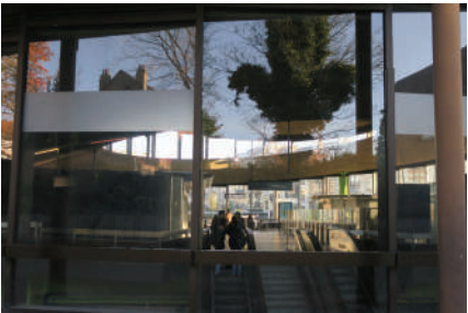
De huidige beglazing is niet transparant.
